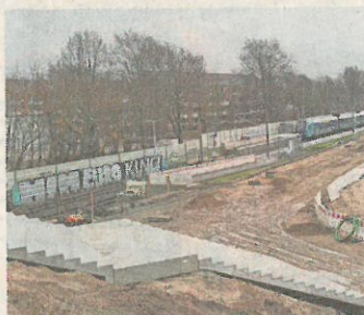
So sah's am 11. Dezember aus: Mittlerweile ist der Bahnhaltepunkt Lübeck-Moisling fast fertig.
