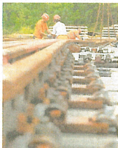
Präzisionsjob: Bauarbeiter präparieren bei Brieselang in Brandenburg eine fertig montierte neue Weiche für den Ausbau der Strecke Berlin-Hamburg.
